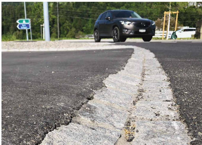
1. Negatives Beispiel eines Randabschlusses mit Belags-Überbau und zu steilem Winkel.
